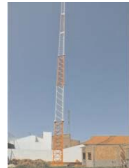
Antena de rádio instalada em Pirangi/SP
